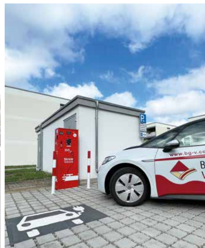
Langstr. 6-10 Ladesäule für E-Autos
